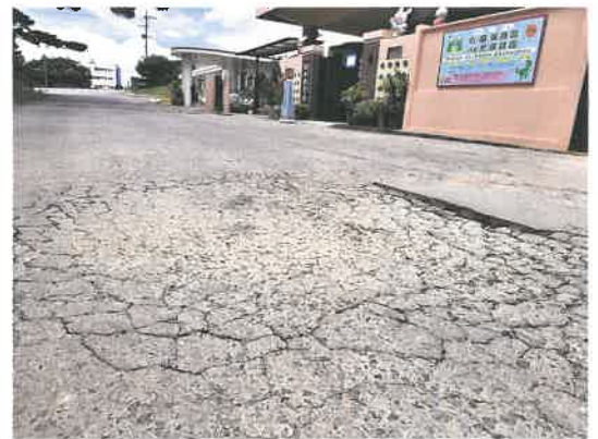
危険！松田保育園前の陥没した道路
