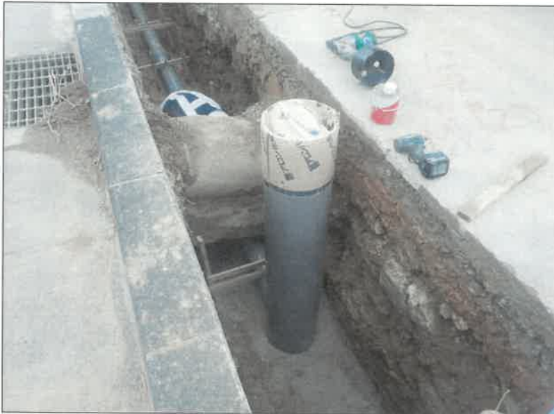
工種:人孔設置工 種別:小型マンホール工 写真タイトル: 設置完了 撮影箇所: MH#28
