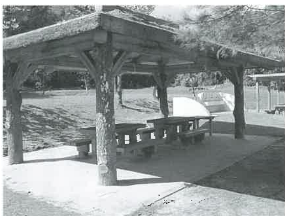
塩害で腐食した施設！！
