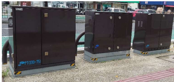
写真3 電線共同溝方式による無電柱化 宜野湾市内設置 地上機器
