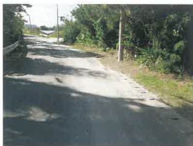
村道城原中央線のマンホール周辺
