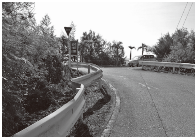
平成26（2014）年8月29日 ガードレール破損
